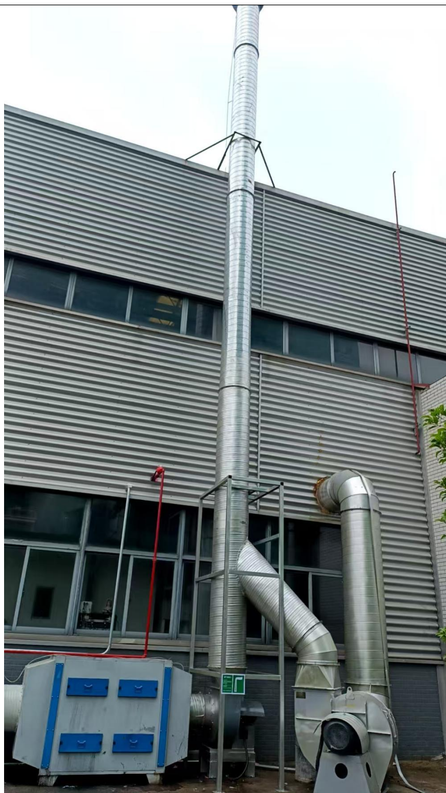
废气处理设施
